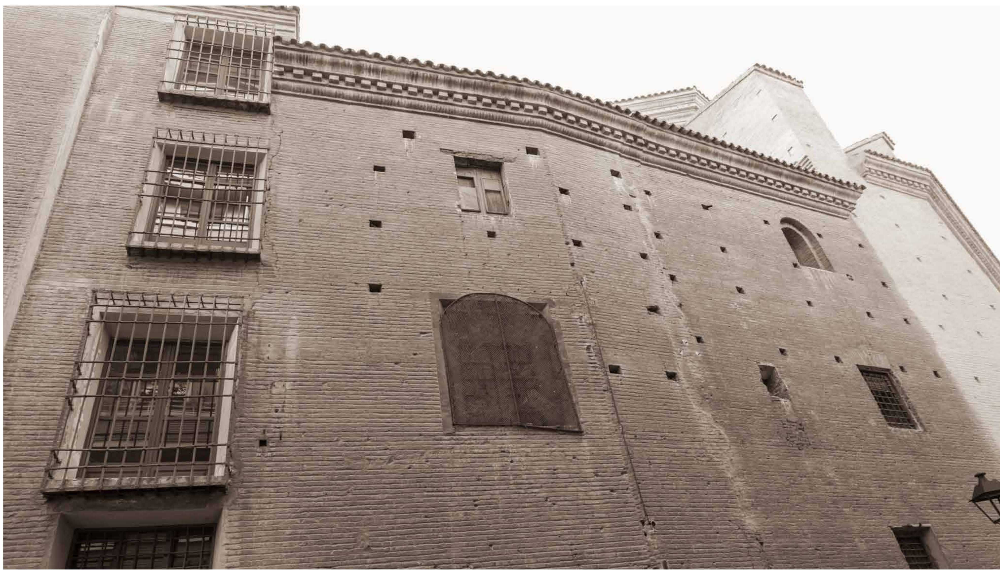
Una de las fachadas laterales de la iglesia de San Carlos, que muestra los impactos de bala de la época de los Sitios.
